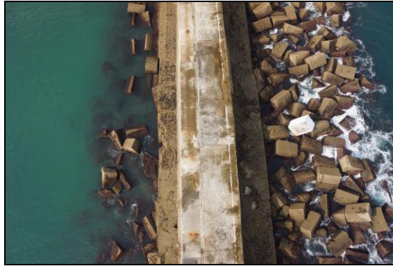
Figure 4 : photo par drone d'un des blocs carrelés en blanc à droite
